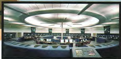
Centre de contrôle.
